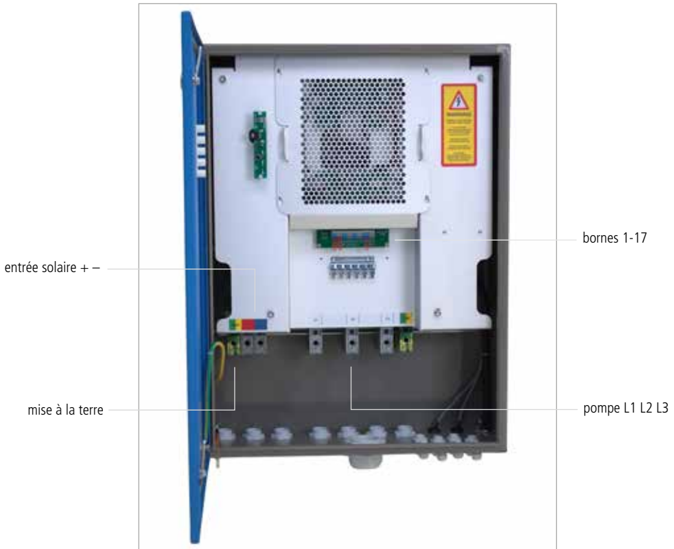
Figure 19: Vue du contrôleur PSk2-60 à PSk2-100 ouvert
